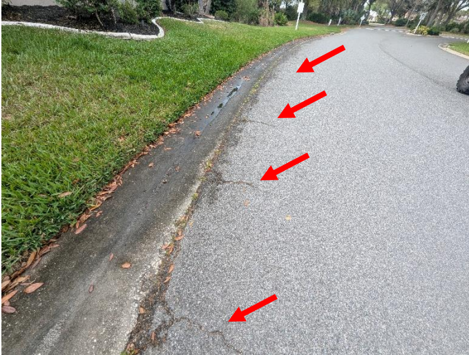
Typical Edge Cracking – Long Lake Ln
