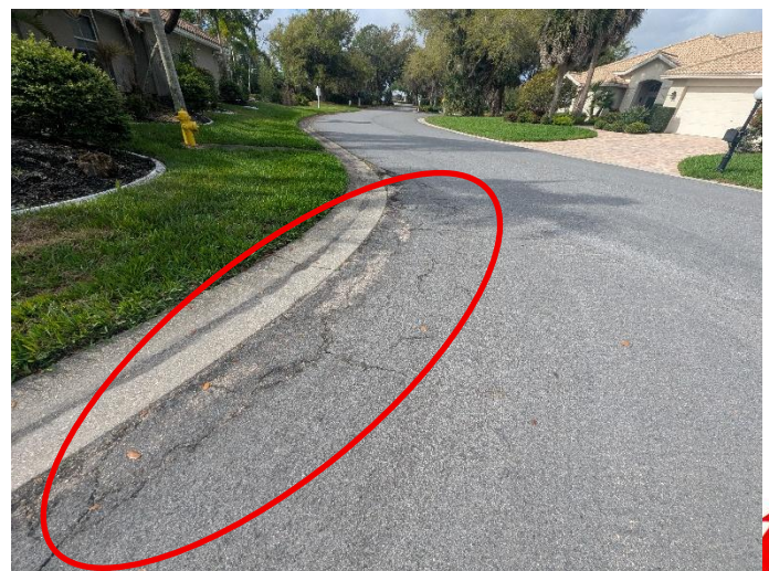
Alligator & Edge Cracking - Palmetto Point Ct
